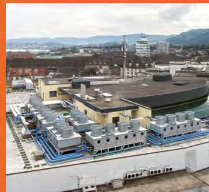
Befestigte Rohre der Kältezentrale auf dem Dach
